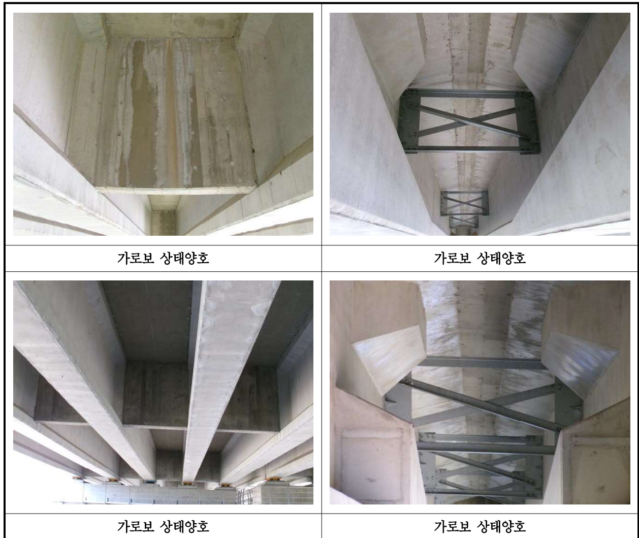
【사진 34.3.7】 가로보 손상현황
