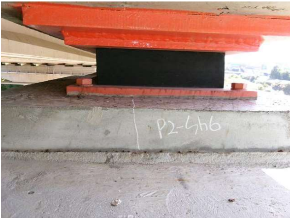
P2-Sh6 무수축물탈 균열(Cw=0.3mm미만)
