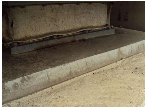
P6-Sh6 무수축물탈 균열(Cw=0.3mm미만)
