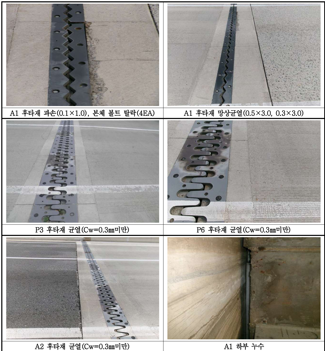
【사진 34.3.17】 신축이음장치 손상현황
