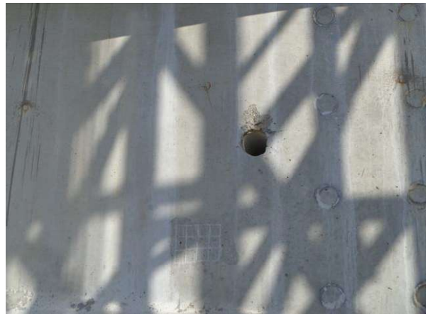
S6-G1 인양홀 파손(0.1×0.1)
